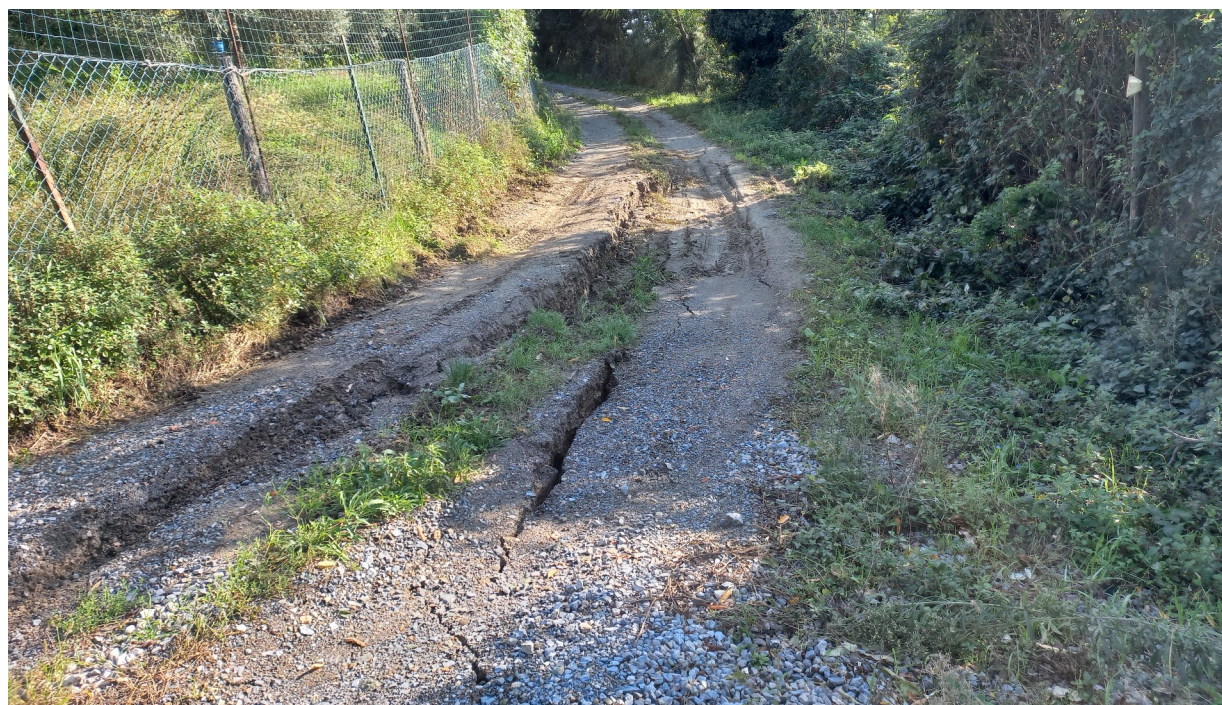
Foto 2 –zona di dissesto principale
