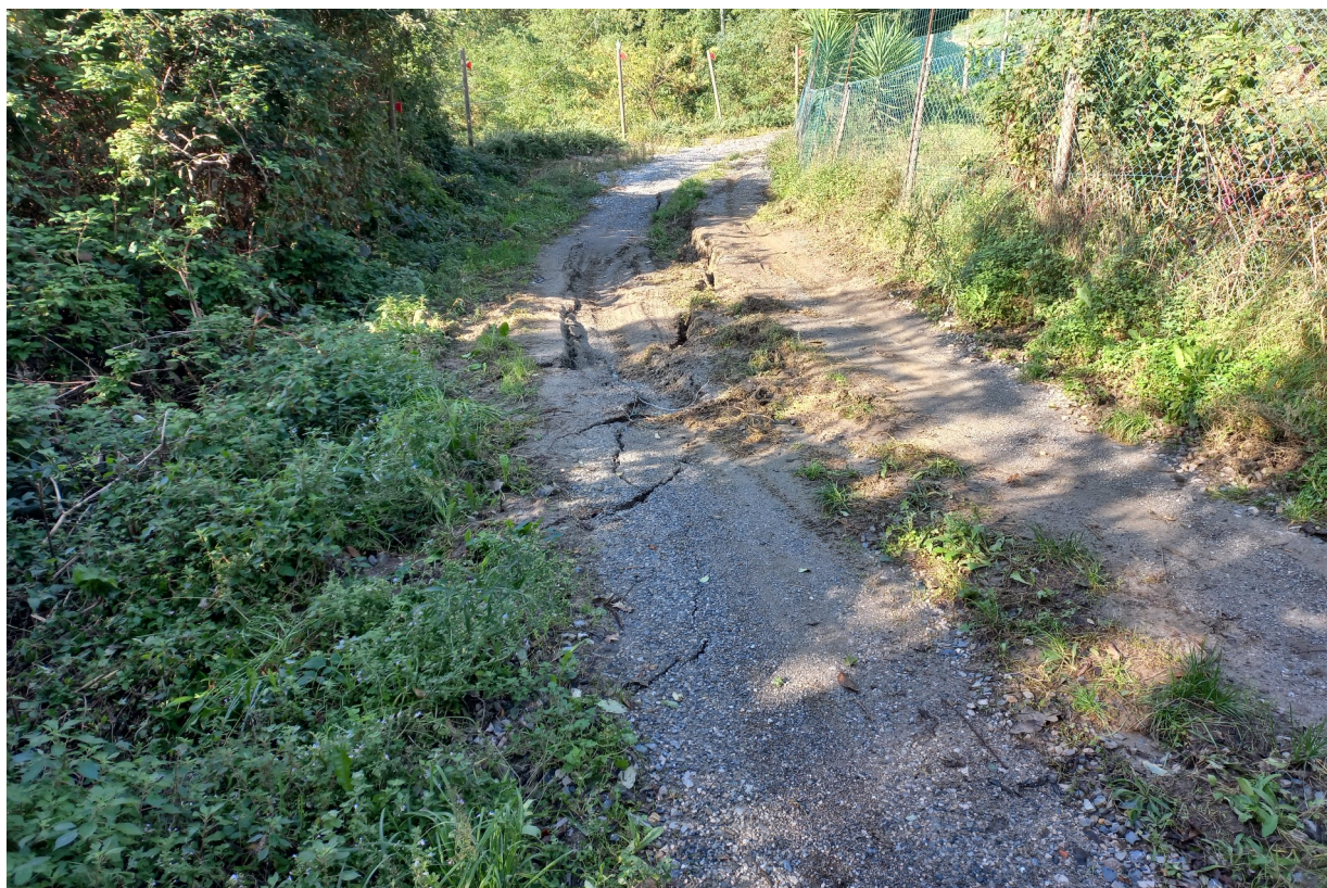
Foto 1 –zona di dissesto principale
