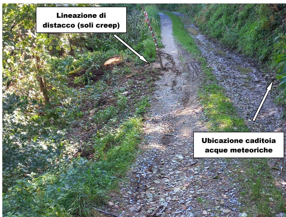
Foto 2 –zona di dissesto principale
