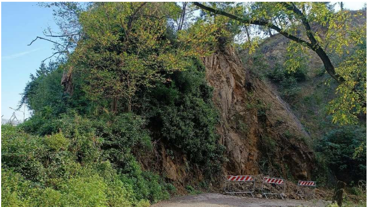
Foto panoramiche della scarpata interessata dal crollo del terreno sommitale, con mobilitazione di terra, blocchi e prismi lapidei e accumulo al piede, con proiezione sulla Via Rossini
